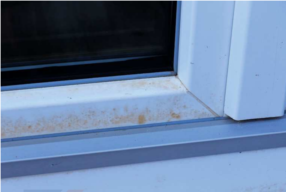
Typische gele verkleuring op het onderste vleugelprofiel van een kunststof venster: de gele verkleuring eindigt zijdelings ter hoogte van de lasnaden. Foto's: Jürgen Sieber
